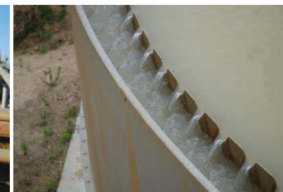
surverse de l'eau claire d'un clarificateur
