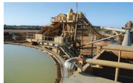
installation avec son clarificateur
