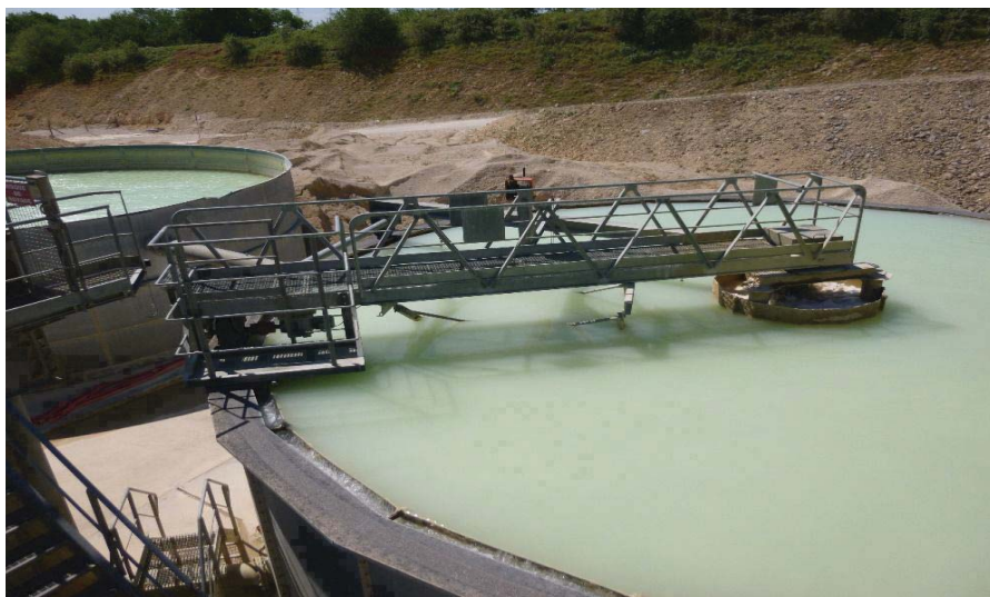
unité de clarification en fonctionnement
